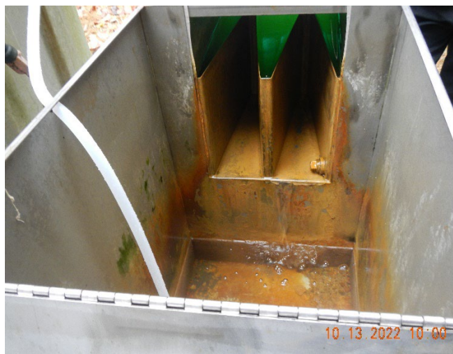
Picture 3. Effluent discharge.
