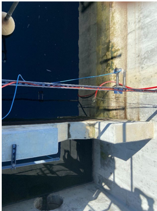
Photo 6: Effluent weir (no discharge).
