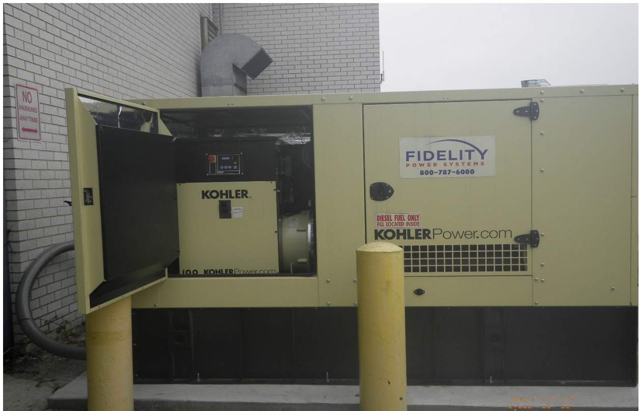
6. EG2: 100kW Kohler Generator – WMATA Bladensburg – 10/25/22
